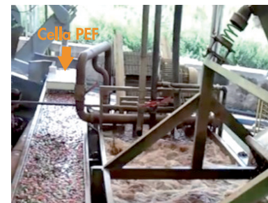
Prove sull'impianto industriale
